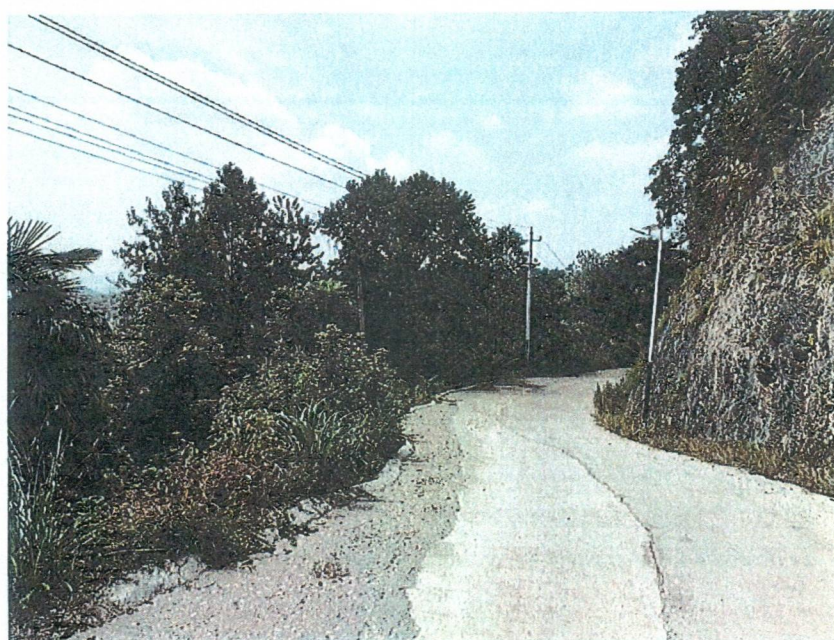
水库取水口周边沿线乡村道路无保护区标志牌
